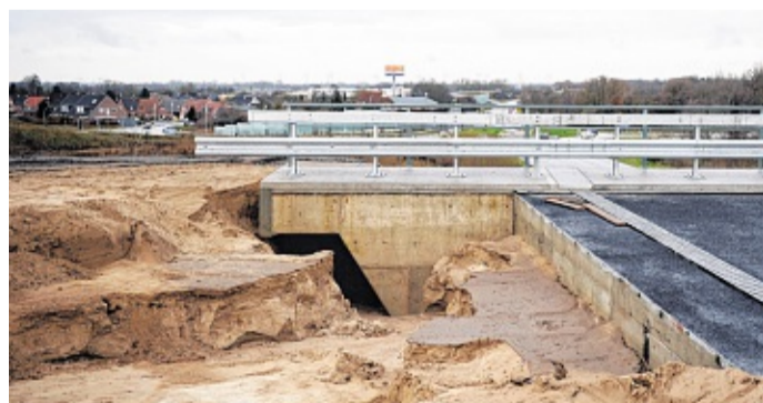
Blick von oben: Zehn Kubikmeter Sand wurden ausgespült. DPA
